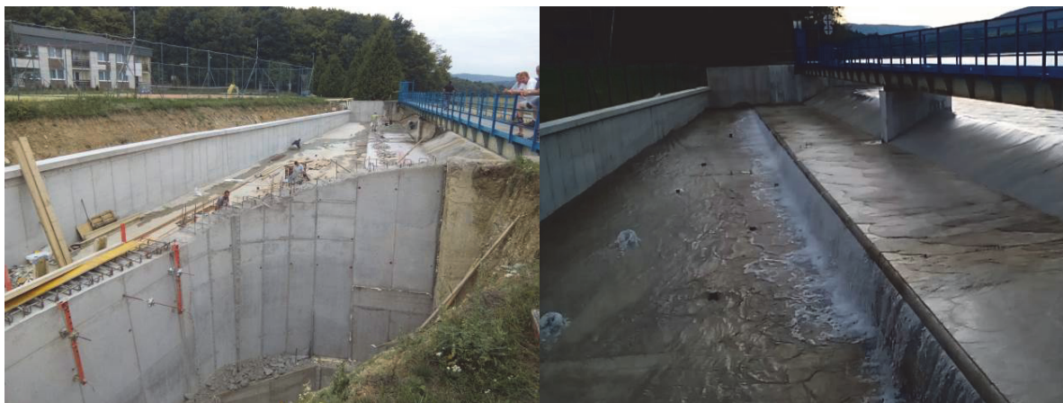
Obr. 3. V roku 2015 zrealizoval SVP, š.p. na priehrade Teplý Vrch rekonštrukciu bezpečnostného priestoru a časti sklzu, čím sa výrazne zvýšila jeho kapacita, avšak iba na úroveň Q_{100} .
