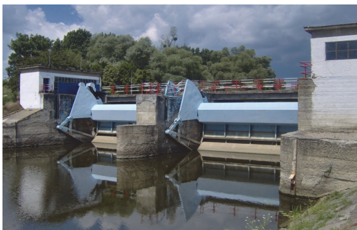
Obr. 2. Napúšťací a vypúšťací objekt poldra Beša. Fig. 2. Filling and discharge object of polder Beša.
